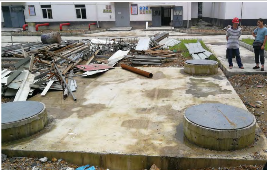
地埋式事故油池
